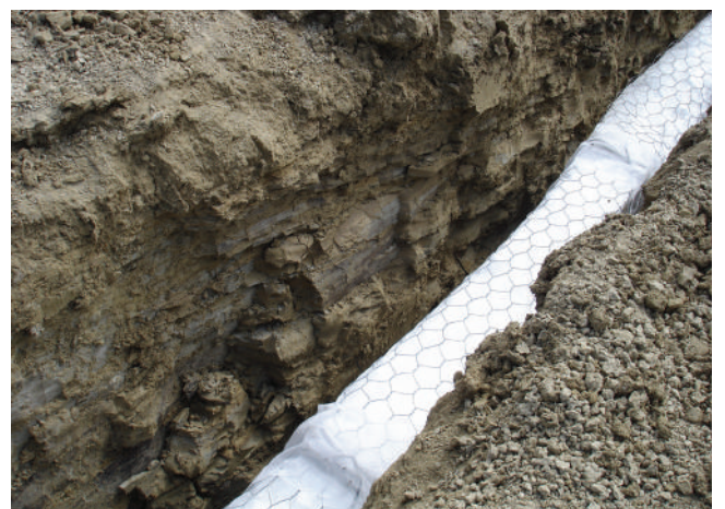
FOTO 3 - Linea drenante in trincea con evidenza delle litologie di copertura e delle loro caratteristiche litologiche e tessiturali
