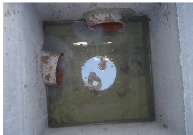
FOTO 6 - Il dettaglio di uno dei pozzetti di raccordo tra trincee e collettore di base mette in evidenza la funzionalità del sistema drenante già attivo durante le fasi di posa
