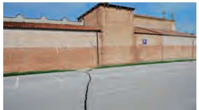
Figura 3 – Cimitero di Sant'Agostino: fratture
