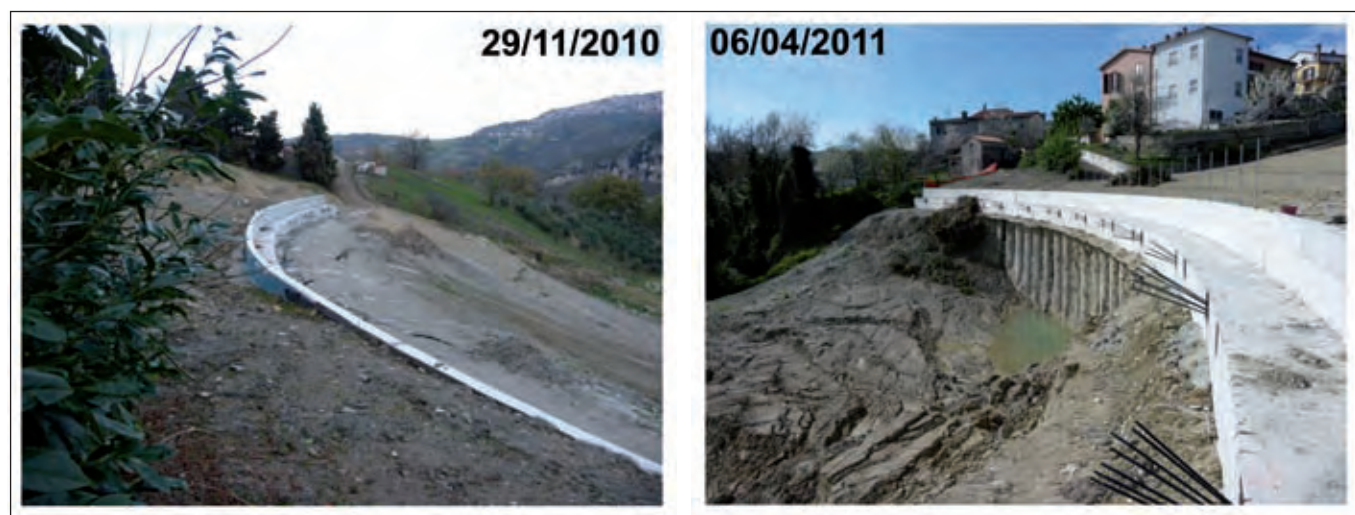
Figura 10 – Riprese fotografiche dei fenomeni di dissesto dopo la realizzazione delle opere di sostegno. Si osserva il vistoso scalzamento a valle della paratia.
