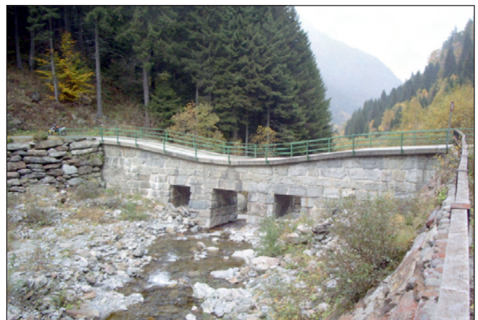
Figura 14 - Briglia filtrante costruita dopo l'evento del 1987.
