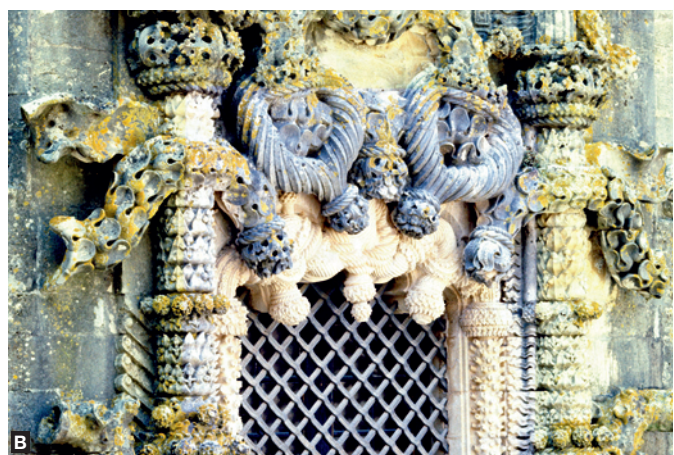
Fig. 13 – Un monumento in calcare se la qualità dell'aria è buona appare tappezzato di licheni soprattutto nelle parti aggettanti, mentre i sottosquadri risultano rivestiti da una patina bruno-rosa-camoscio [di cui si parla diffusamente nel testo; cfr. supra fig. 10]: ciò risulta particolarmente evidente nella parte interna del rosone, nell'area sopra la grande finestra protetta dalla sovrastante modanatura e nelle nicchie laterali [a]. L'ingrandimento della cimasa della finestra, in stile manuelino, mette meglio in evidenza la fittissima colonia di licheni che ricopre le parti più esterne, e la "vernice" rosa-camoscio presente nelle aree arretrate sottostanti [b]. Un secondo particolare dello stesso monumento: l'origine naturale della patina bruna a ossalati di calcio, sotto la mensola, appare in questo caso evidentissima [c] [Convento dei Templari do Cristo, Finestra del Capitolo, Tomar, Portogallo, calcare dolomitico].
