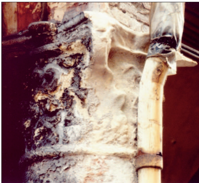
Figura 15 – Altro esempio, simile al precedente, che mostra come la mancanza di manutenzione ordinaria, favorendo il ruscellamento e l'infiltrazione dell'acqua di pioggia – soprattutto nel caso di parti sporgenti come la sommità di capitelli, marcapiani, mensole e quant'altro – porti spesso a danni rilevanti (Bologna, già case Sala, via Farini n. 21).
