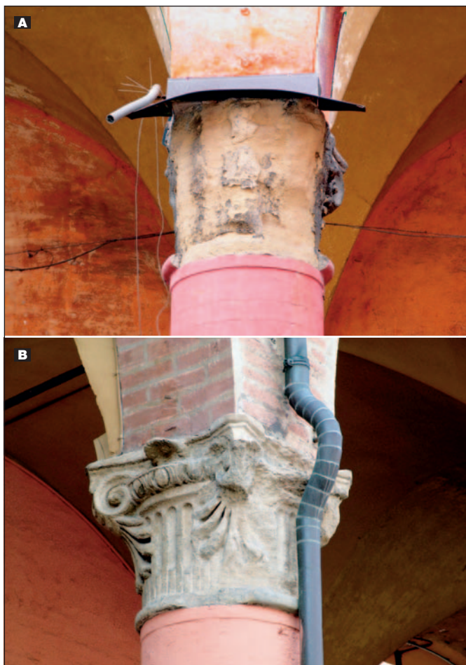
Figura 14 a – Particolarissima attenzione dovrebbe essere portata, in presenza di elementi decorativi, come capitelli in arenaria, all'allontanamento dell'acqua di pioggia: ad esempio la manutenzione ordinaria e continua dei tubi delle grondaie è una pratica da seguire sempre con estrema cura. E' spesso possibile osservare che i tubi verticali di scolo sono stati sostituiti a danno avvenuto e non prima. Anche la pratica, utilissima di ricoprire la sommità del rilievo con una lamina di piombo (che si passiva in superficie; meno utile è invece il rame!) che favorisce l'allontanamento dell'acqua di pioggia impedendo sia il ruscellamento sia l'infiltrazione andrebbe fatta prima e non dopo che il danno è avvenuto. Il capitello, nella foto in alto, è stato protetto dall'acqua, appunto a danno avvenuto: ciò è ineccepibile avendo funzione portante anche se non c'è dubbio che sarebbe stato meglio intervenire prima. b - Curiosamente un capitello simile in opera a pochi metri da questo non presenta alcuna protezione: forse si aspetta, per intervenire, che faccia la fine del primo! (Bologna, capitelli in arenaria, Piazza Verdi).
