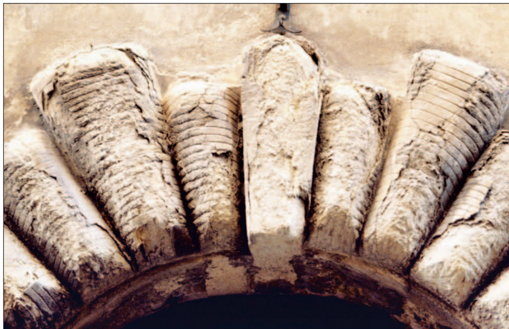
Figura 6 – Esfoliazione superficiale di blocchi in arenaria utilizzati in un piccolo portale: la foto riproduce la parte sommitale dell’arco e mette in evidenza come i conci sporgano – di una trentina di centimetri – rispetto la facciata dell’edificio e quindi vengano facilmente raggiunti dall’acqua di pioggia. Il portale si trova in una strada strettissima e viene al contrario raramente e per poco tempo scaldato dai raggi del sole. Per questo l’acqua di infiltrazione permane a lungo nella pietra e, dato che la temperatura scende per molte notti invernali sotto lo zero termico, questa subisce il fenomeno della crioclastia degradandosi (Camerino – Macerata).
