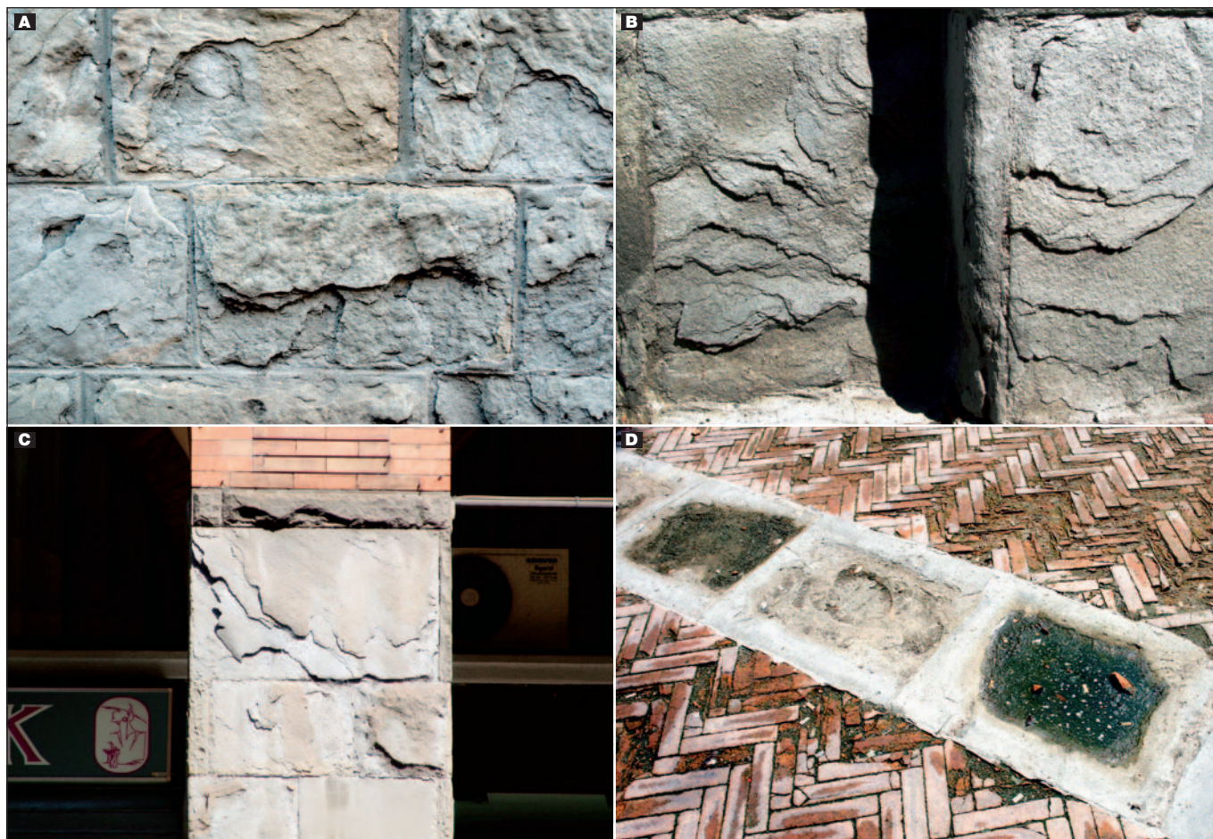
Figura 2 - Le arenarie laminate non dovrebbero mai essere messe in opera con la laminazione (o verso) parallelo alla superficie di esposizione: ciò porta inevitabilmente al distacco di scaglie o in certi casi addirittura di intere lastre. Se vengono utilizzate per lastricare strade o piazze, posizionate coi piani di laminazione orizzontali, vale a dire col verso parallelo alla superficie del suolo si assiste alla formazione di alveoli che tendono ad approfondirsi col passare del tempo anche perché poi qui l'acqua di pioggia staziona a lungo. (Bologna, a: via s. Margherita n. 1; b,c: via dell'Indipendenza n. 67; d: piazzetta della Chiesa di Santa Maria dei Servi).
